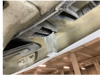
Tampon, arka, Bağlantı ayağı > Hasarlı
