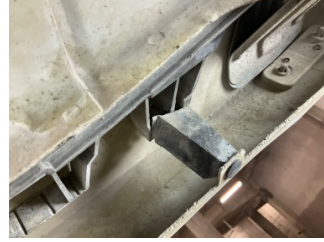
Tampon, arka, Bağlantı ayağı > Hasarlı
