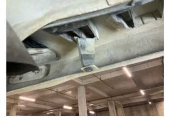
Tampon, arka, Bağlantı ayağı > Hasarlı
