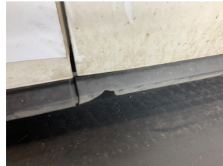
Marşbiyel, sağ, Marşbiyel plastığı, sağ > Hasarlı
