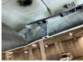
Tampon, arka, Bağlantı ayağı > Hasarlı
