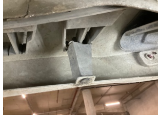
Tampon, arka, Bağlantı ayağı > Hasarlı
