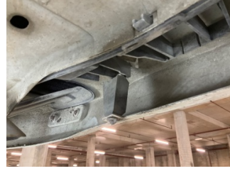
Tampon, arka, Bağlantı ayağı > Hasarlı
