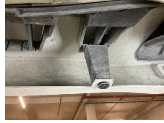
Tampon, arka, Bağlantı ayağı > Hasarlı
