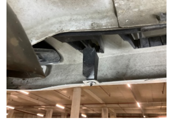
Tampon, arka, Bağlantı ayağı > Hasarlı
