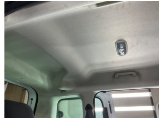
Döşemeler/Kapaklar, Döşemeler/Kapaklar > Kirlenmiş
