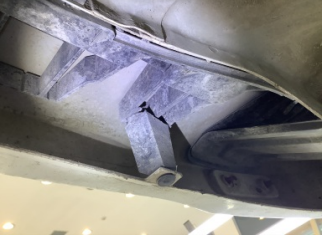
Tampon, arka, Baęlantı ayaęı > Hasarlı
