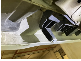
Tampon, arka, Bağlantı ayağı > Hasarlı
