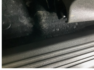
Döşemeler/Kapaklar, Döşemeler/Kapaklar > Yakıcı Madde ile Zarar Görmüş
