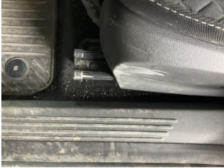
Döşemeler/Kapaklar, Döşemeler/Kapaklar > Deforme Olmuş
