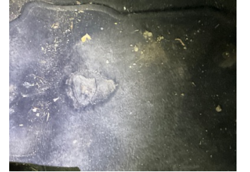
Döşemeler/Kapaklar, Döşemeler/Kapaklar > Deforme Olmuş
