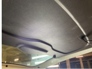
Döşemeler/Kapaklar, Döşemeler/Kapaklar > Deforme Olmuş
