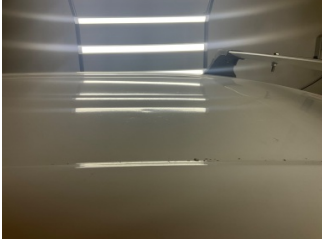
Tavan, Tavan > Dolu Hasarı
