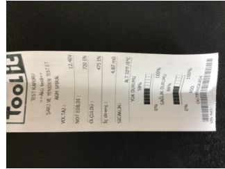
Elektrik donanımı/Pano, Akü > Test Sonucu
