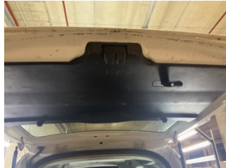
Döşemeler/Kapaklar, Bagaj kapağı, iç döşemesi > Çizik
