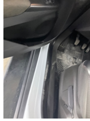
Döşemeler/Kapaklar, Döşemeler/Kapaklar > Dikişleri Açılmış
