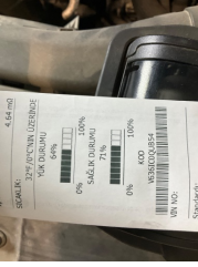
Elektrik donanımı/Pano, Akü > Test Sonucu
