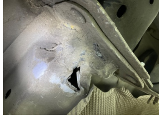
Kaporta, Sol Arka Şase > Hasarlı
