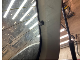
Döşemeler/Kapaklar, Pandizot > Kırılmış
