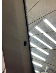
Döşemeler/Kapaklar, Pandizot > Kırılmış
