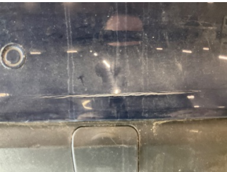
Tampon, arka, Arka tampon > Çatlak
