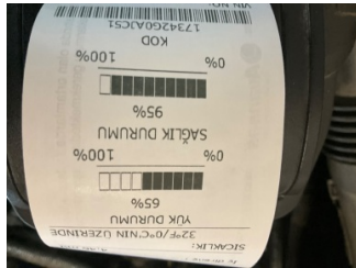
Elektrik donanımı/Pano, Akü > Test Sonucu
