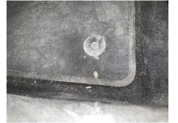
Döşemeler/Kapaklar, Döşemeler/Kapaklar > Yakıcı Madde Ile Zarar Görmüş
