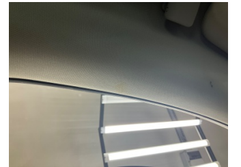
Döşemeler/Kapaklar, Döşemeler/Kapaklar > Kirlenmiş
