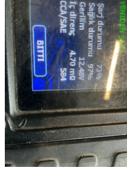
Elektrik donanımı/Pano, Akü > Test Sonucu
