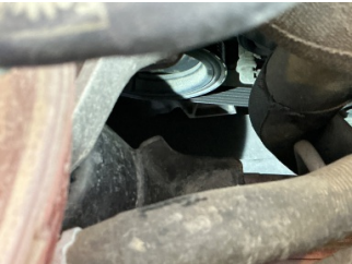
Motorsoğutması, Kayış > Deforme Olmuş
