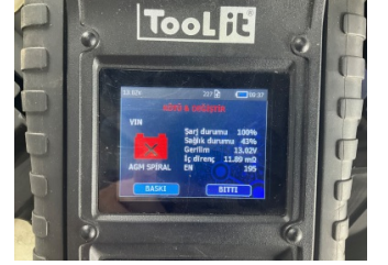
Elektrik donanımı/Pano, Akü > Test Sonucu
