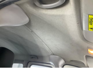
Döşemeler/Kapaklar, Döşemeler/Kapaklar > Kirlenmiş
