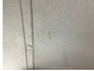
Döşemeler/Kapaklar, Tavan döşemesi > Kirlenmiş
