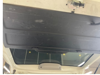
Döşemeler/Kapaklar, Döşemeler/Kapaklar > Çizik
