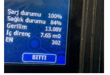
Elektrik donanımı/Pano, Akü > Test Sonucu
