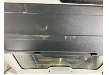
Döşemeler/Kapaklar, Döşemeler/Kapaklar > Deforme Olmuş
