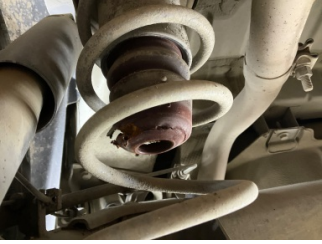
Arka aks, Amortisör körüğü, sol > Hasarlı
