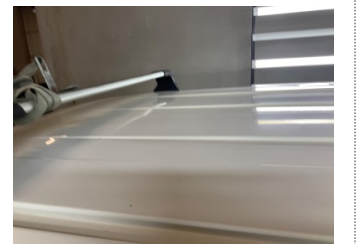
Tavan, Tavan > Hasarlı
