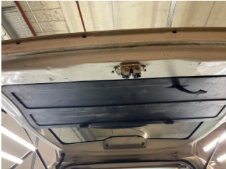
Döşemeler/Kapaklar, Döşemeler/Kapaklar > Çizik
