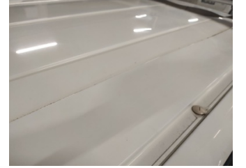
Tavan, Tavan > Hasarlı
