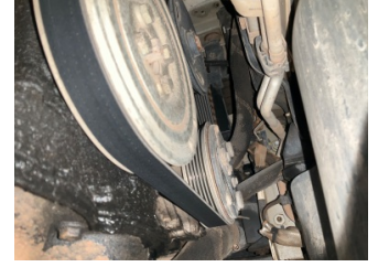
Motor, Motor > Yağ Kaçağı
