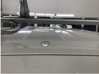
Tavan, Tavan > Hasarlı
