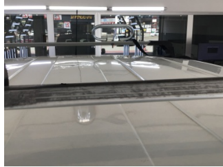
Tavan, Tavan > Hasarlı
