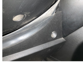
Döşemeler/Kapaklar, Döşemeler/Kapaklar > Sabitlemesi Hatalı
