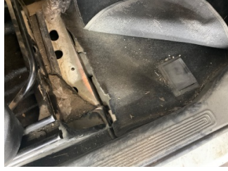
Taban, Taban halısı > Deforme Olmuş
