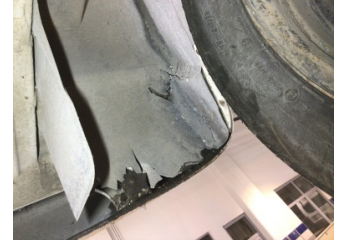
Motor, Alt muhafaza > Hasarlı
