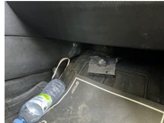
Elektrik donanımı/Pano, Kablo demeti > Onaysız
