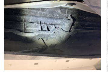
Tampon, arka, Tampon koruyucu orta > Hasarlı
