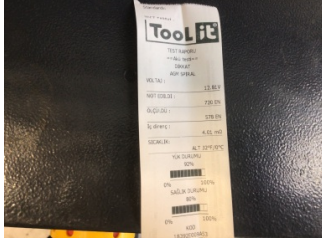
Elektrik donanımı/Pano, Akü > Test Sonucu
