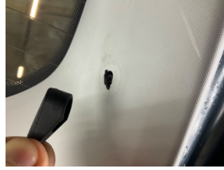
Döşemeler/Kapaklar, Pandizot > Kırılmış
