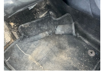
Taban, Paspaslar > Hasarlı
