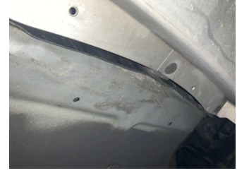
Arka bölüm, Arka sac/panel > Standart Dışı Onarım
