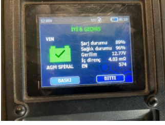
Elektrik donanımı/Pano, Akü > Test Sonucu
