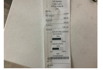
Elektrik donanımı/Pano, Akü > Test Sonucu
