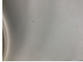
Döşemeler/Kapaklar, Döşemeler/Kapaklar > Kirlenmiş
