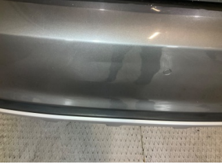
Tampon, arka, Arka tampon > Çatlak
