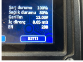
Elektrik donanımı/Pano, Akü > Test Sonucu
