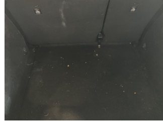
Döşemeler/Kapaklar, Döşemeler/Kapaklar > Kirlenmiş
