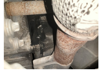
Motor, Motor > Yağ Kaçağı
