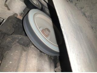
Motor, Motor > Yağ Kaçağı
